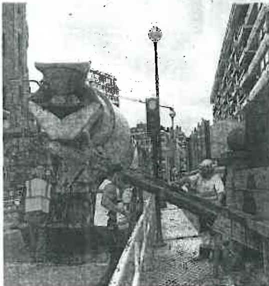
Varios operarios introducen el hormigón para sellar el pilar que quedó en el aire después del hundimiento.
